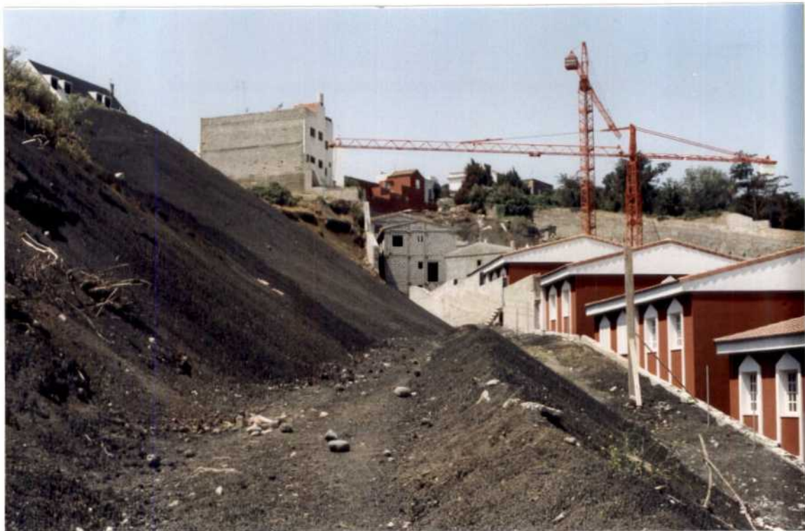
FOTOGRAFIA 6 : Otra vista de la berma intermedia existente en la ladera, con las viviendas adosadas situadas en el pie de la zona "inestable".
