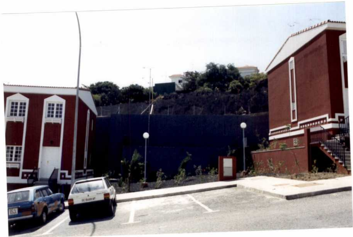
FOTOGRAFIA 2 : Vista de la zona "inestable" desde las viviendas existentes en la parte baja del talud. Observese los pequeños deslizamientos superficiales.
