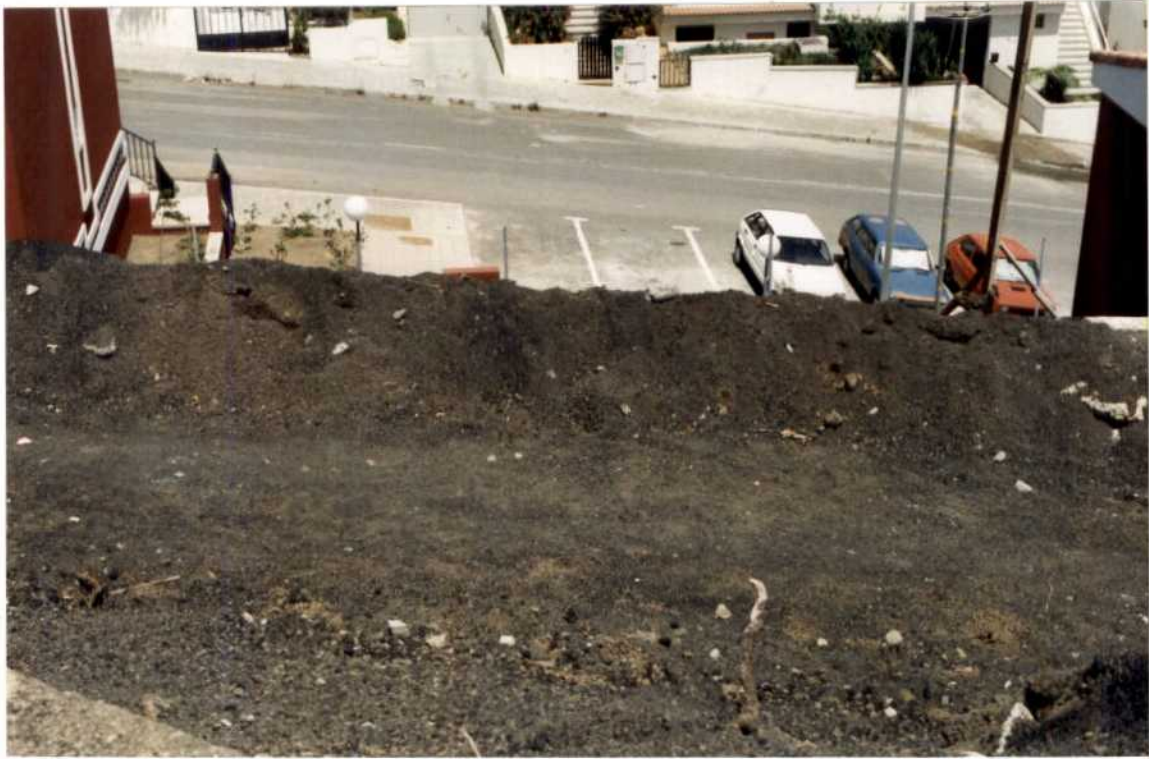
FOTOGRAFIA 5 : Fotografía realizada desde la coronación de la zona "inestable", en la que se observa la berma intermedia existente en el talud.
