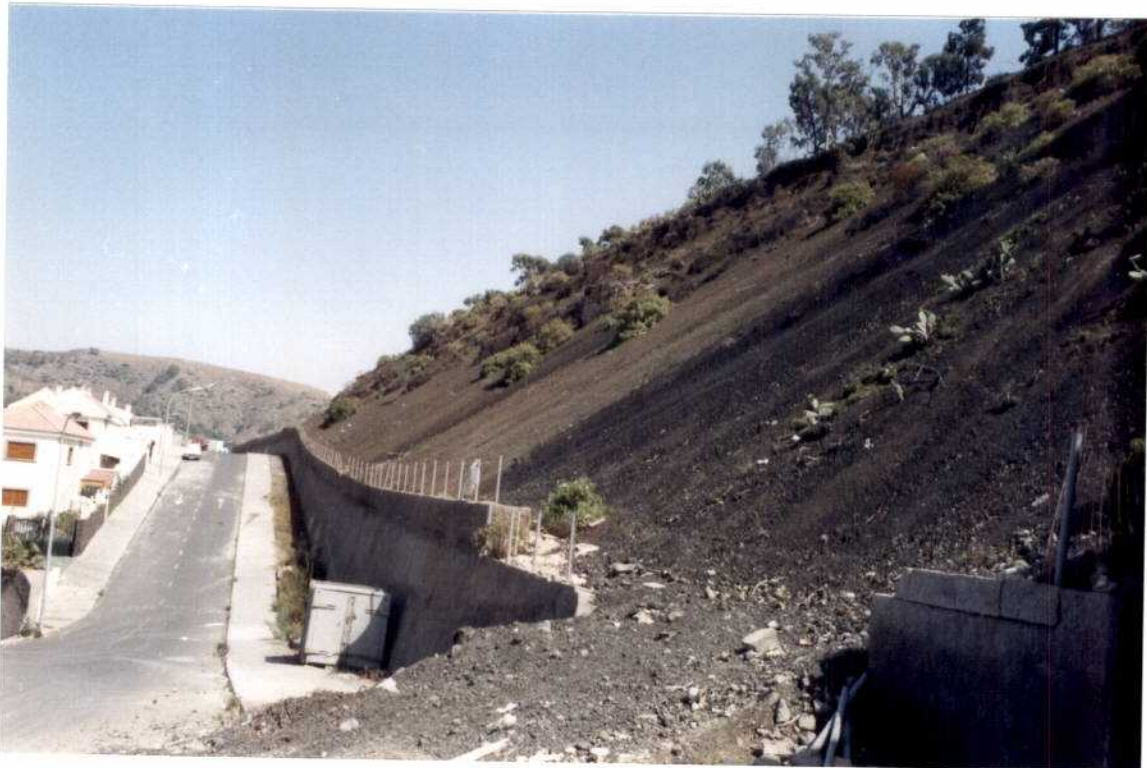
FOTOGRAFIA 8 : Talud abierto en Lapilli basáltico con un Factor de Seguridad próximo a la unidad.
